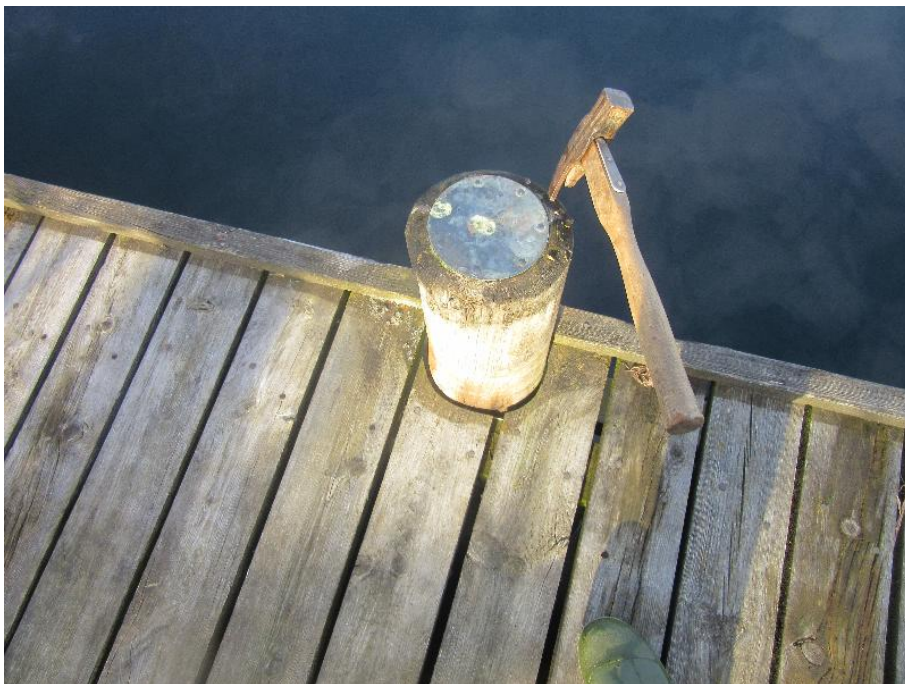
Top af pæl nedbrudt.
