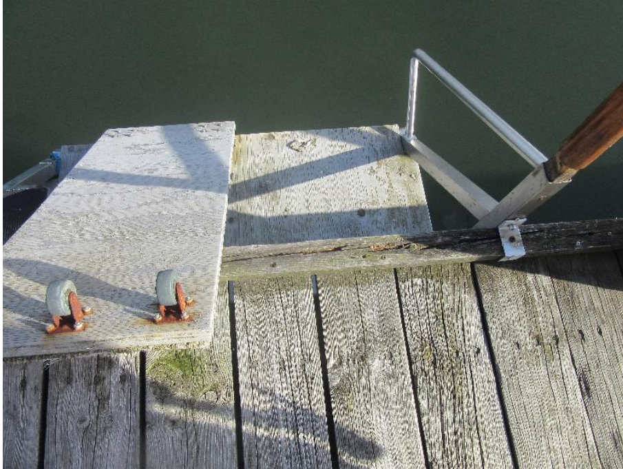
Nedbrudt og flækket kantliste.
