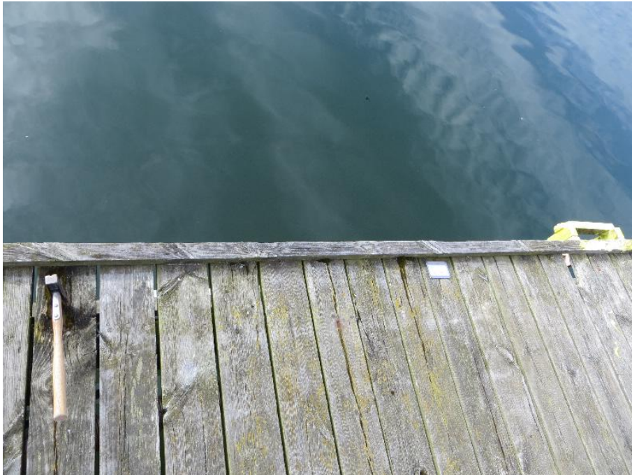
Flere brædder nedbrudte ved plads J29.
