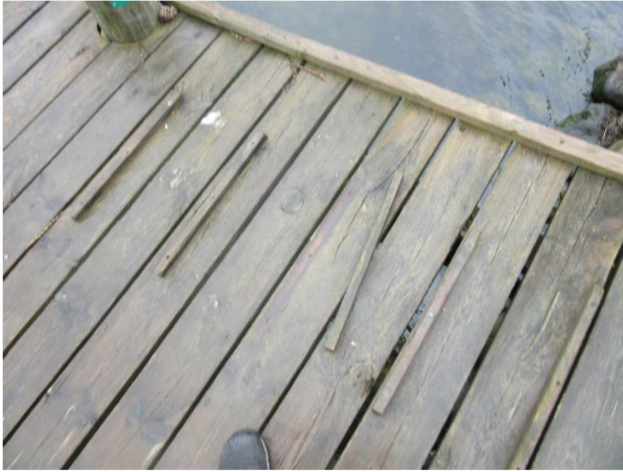
Løs skridsikring på landgangsbro.
