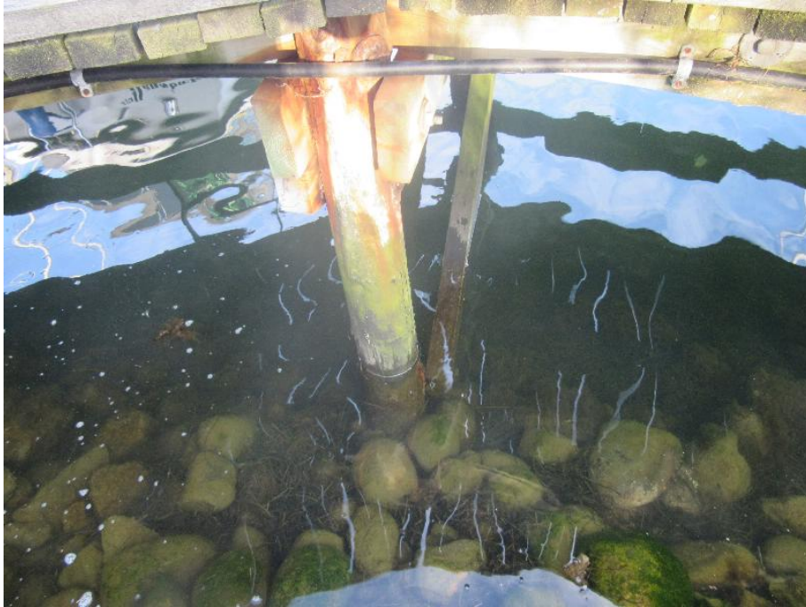
Afstivning løsrevet fra pæl.
