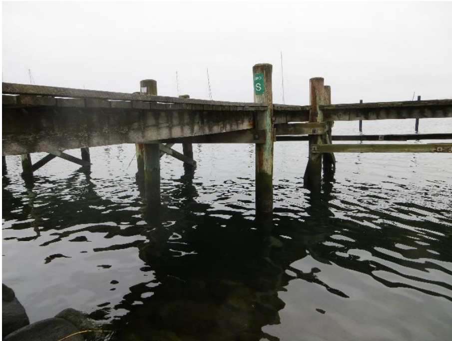
Ældet langsgående bjælker.
