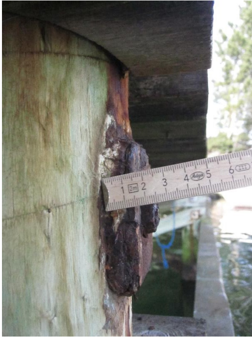
Korrosion på spændeskive og møtrik
