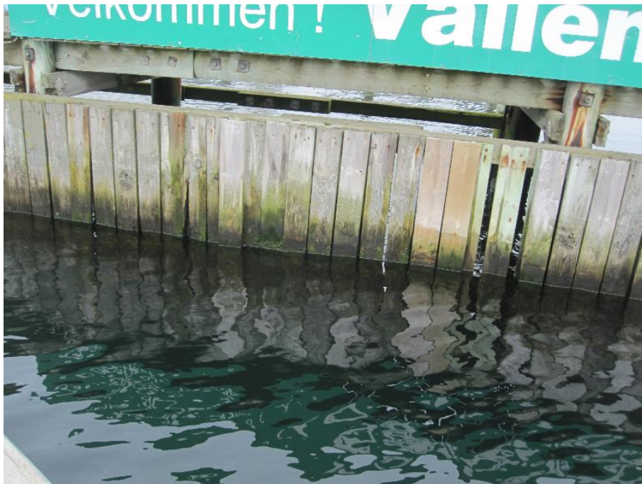
Mangelfuld bræddebeklædning på bølgeskærm
