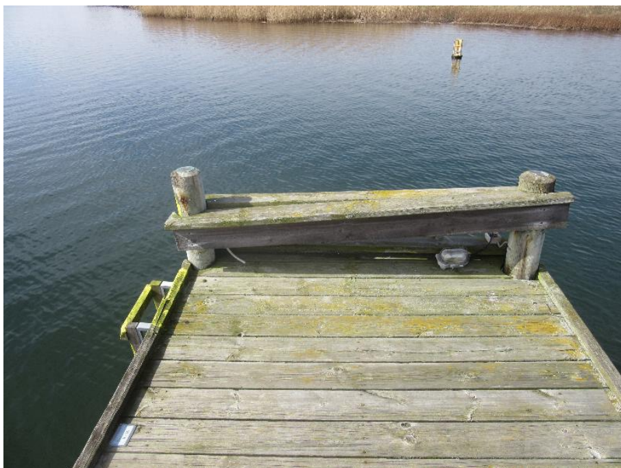
Afdækning ved installationer mangler fastgørelse.
