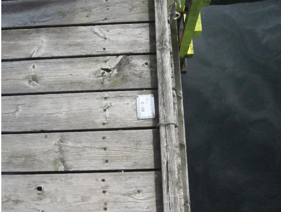
Ældet og revnet kantliste
