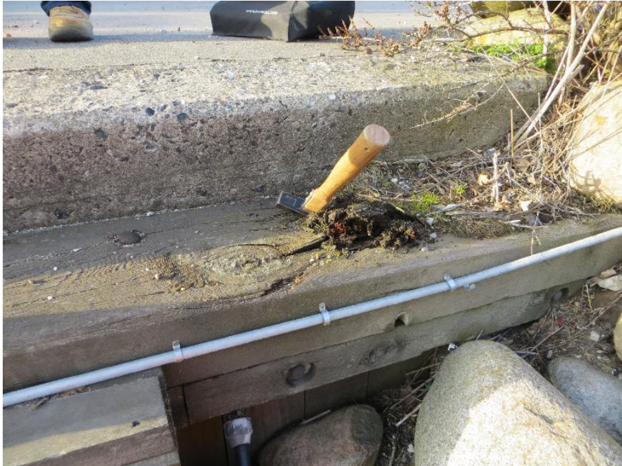
Rådskade mod dæmningen.
