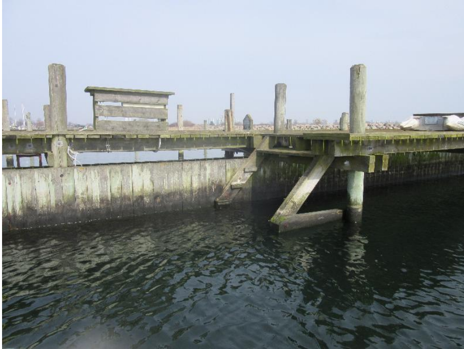
Bølgeskærm, ældet og nedbrudt ved vandspejlet.
