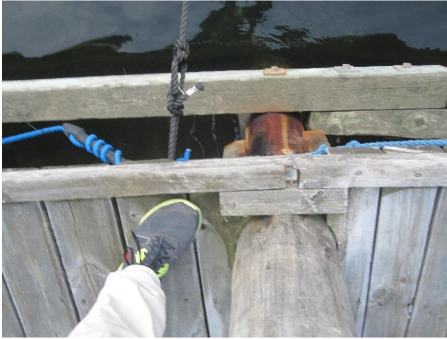
Misfarvning af pæl
