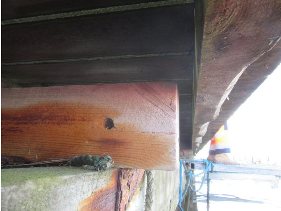
Manglende understøtning af de langsgående bjælker.
