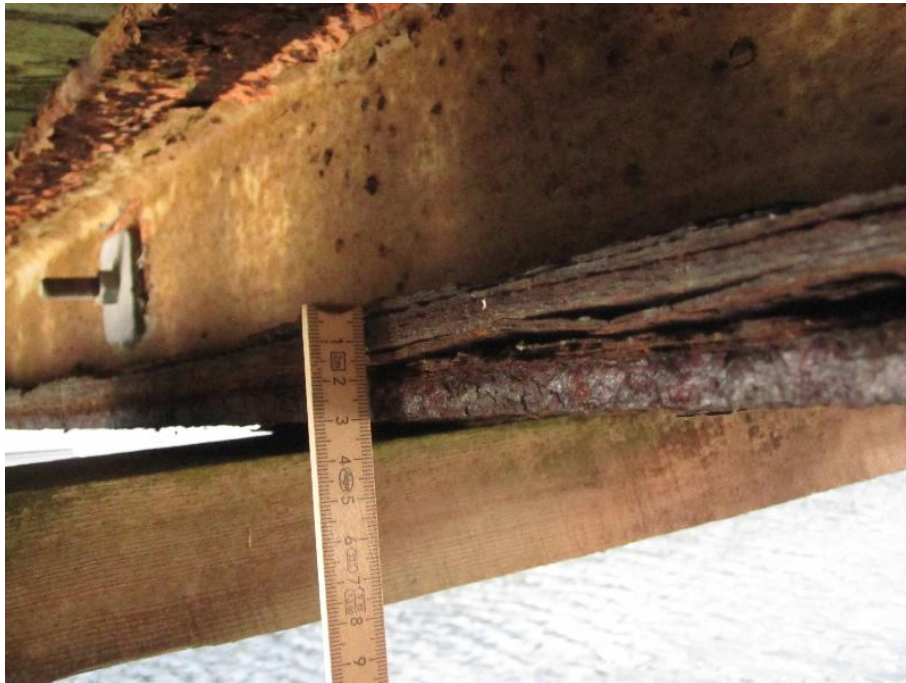
Svær lamineret korrosion på supplerende stålbjælke mellem landfæste og første pælepar.
