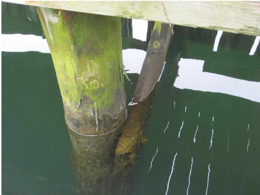
Nedbrydning i endetræ ved afstivning.
