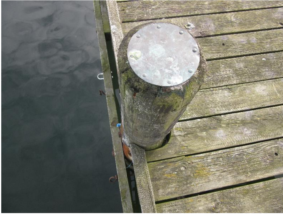
Nedbrudt top på pæl.
