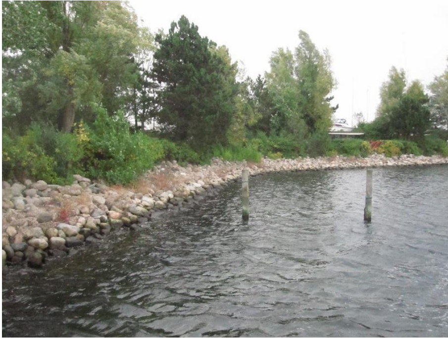
Acceptabel flad stensætning mellem bådebro P og Q.
