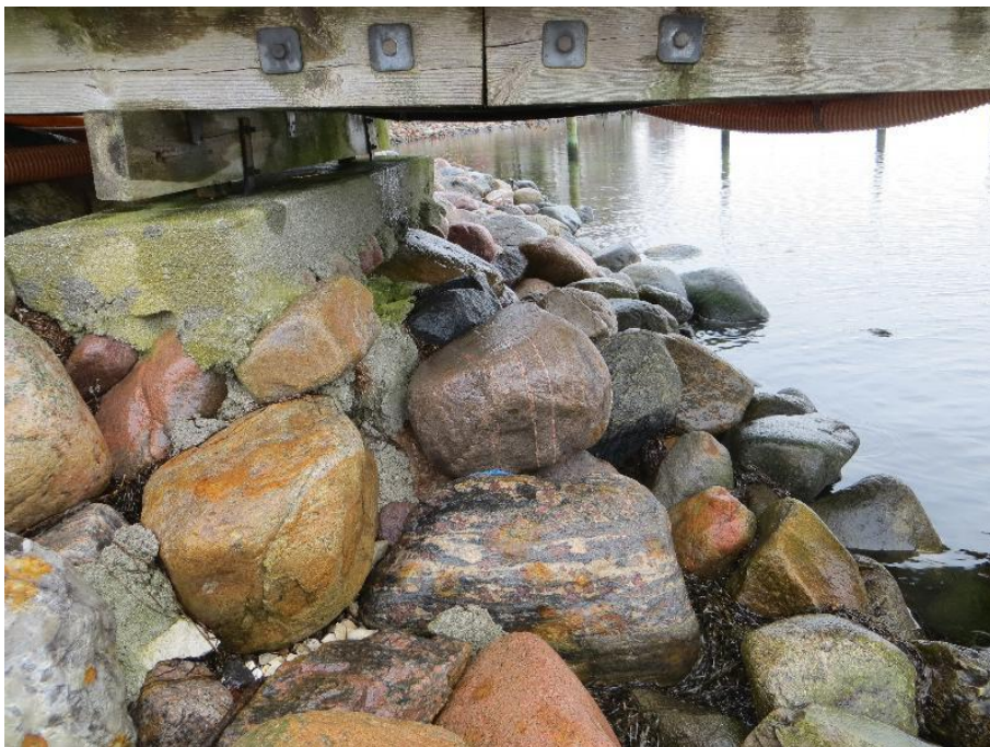
Acceptabel flad stensætning. Fundament har ikke sat sig.
