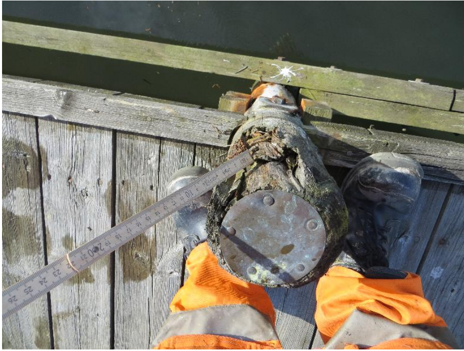
Nedbrydning i toppen af pæl.
