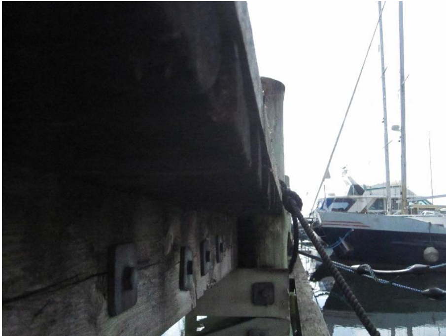
Ældet langsgående bjælker
