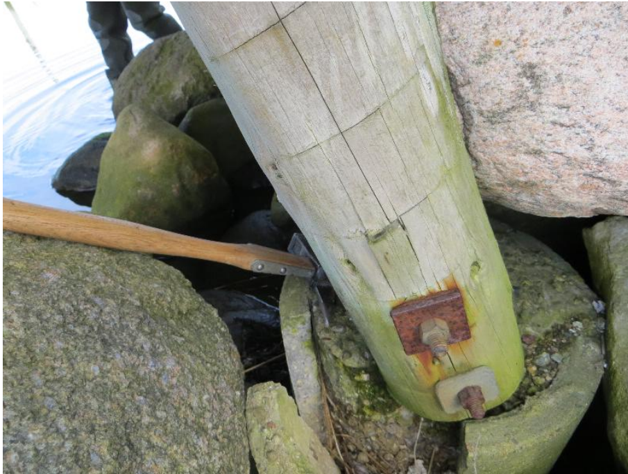
Nordlige ringfundament - knækket.
