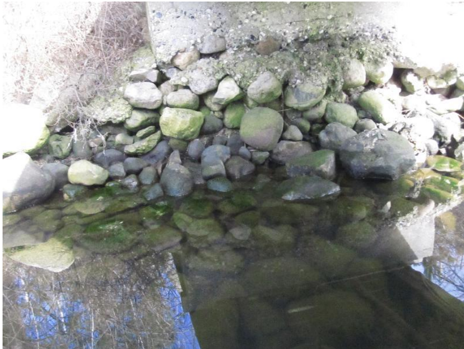
Sten er skredet ved fundament til bådebro F.
