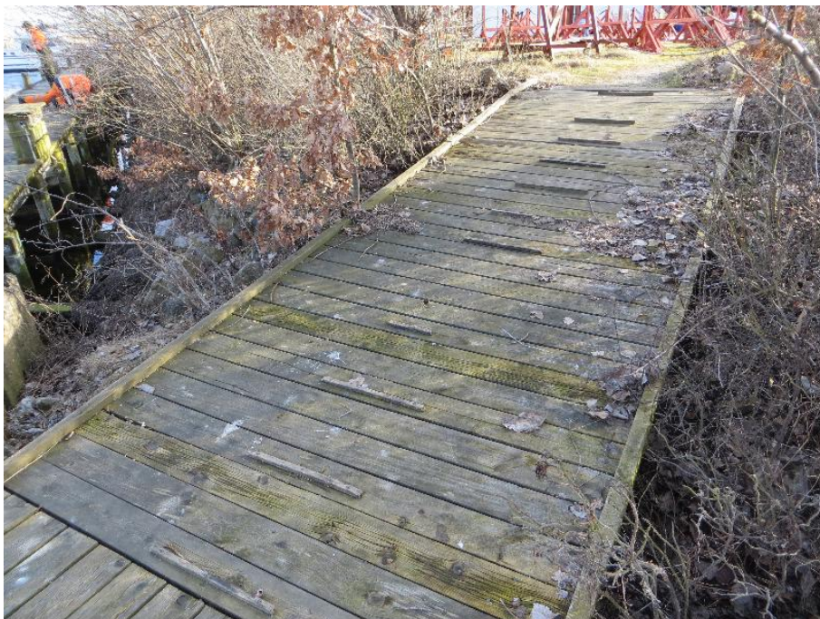
Brodæk og skridsikring er nedbrudt på rampen mod kajakklubben.
