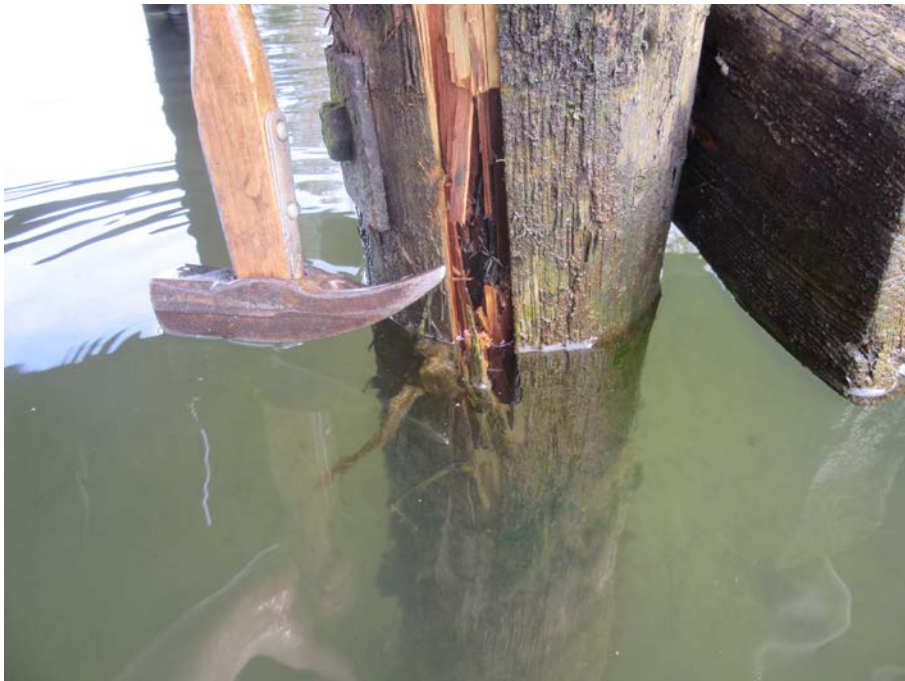
Nedbrydning i pæl ved vandspejlet.
