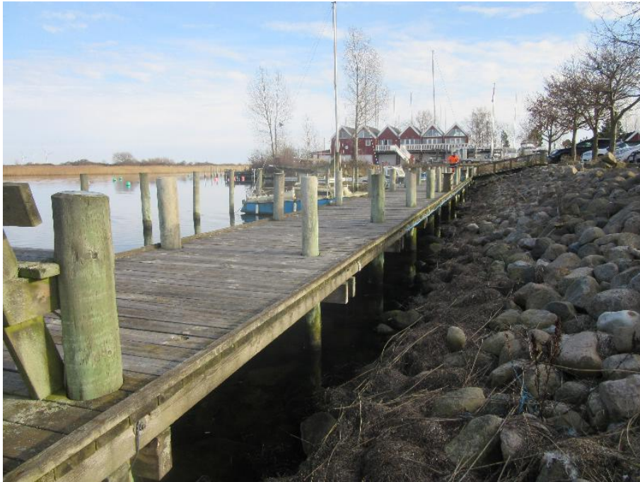
Stensætning Krabben strækning M. Intet at bemærke
