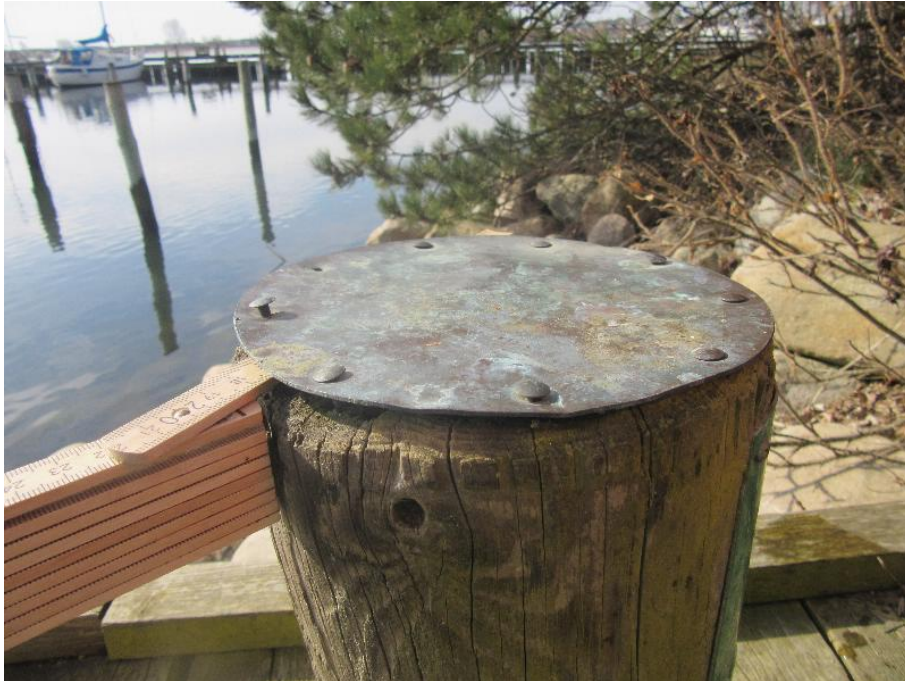
Løs inddækning på pæletop
