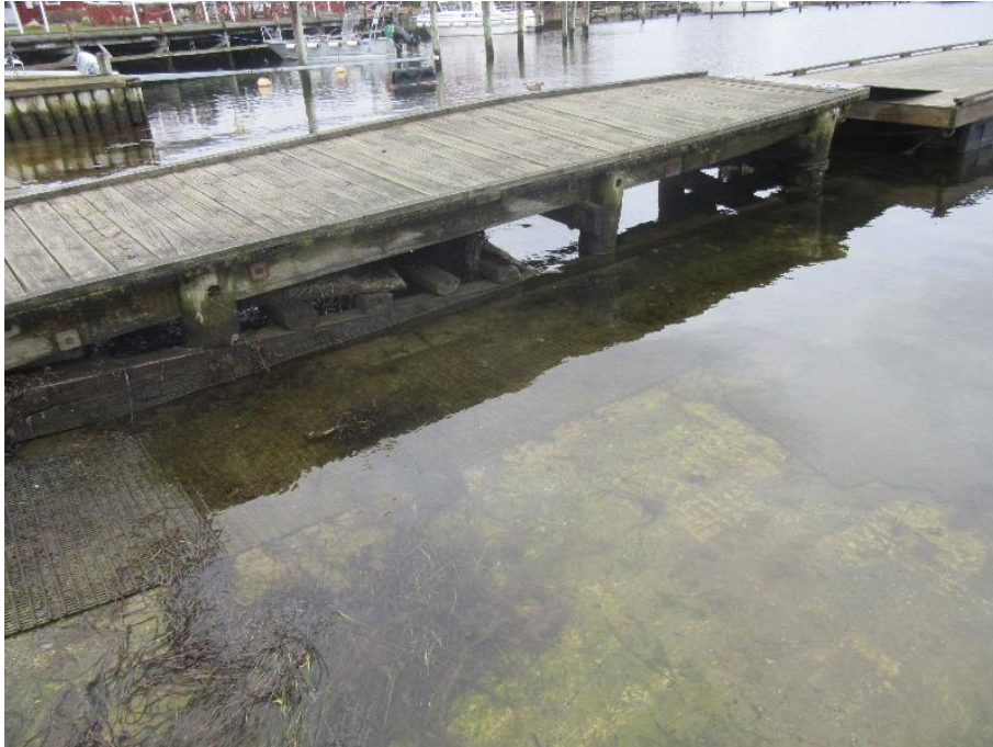
Ældet brodæk på rampe
