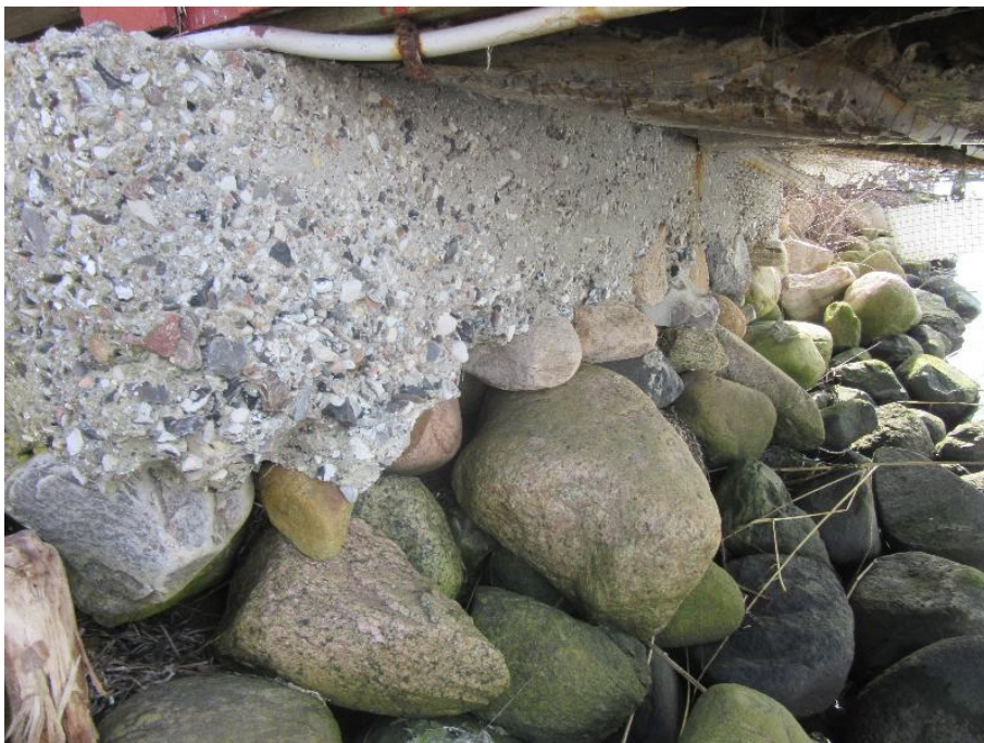
Sten skredet under pumpehus krabben.
