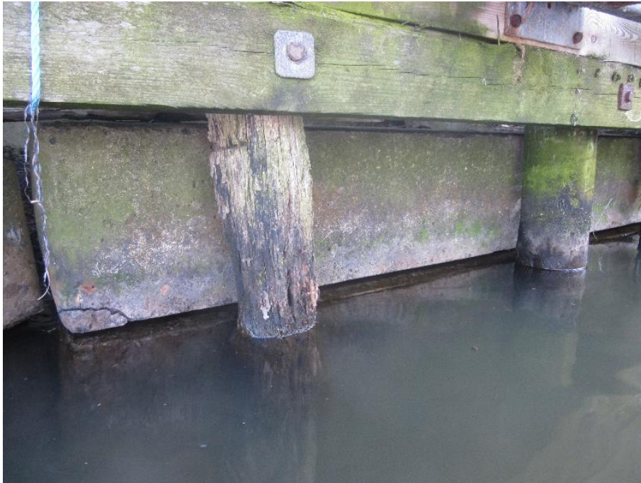
Svært nedbrudt pæl.
