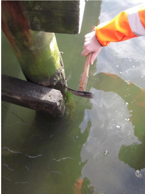
Nedbrudt endetræ på tværafstivning
