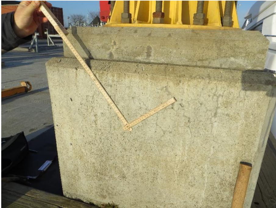
Fine svindrevner på kran fundament
