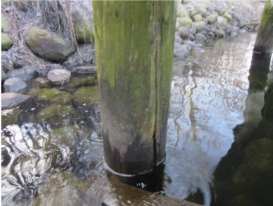
Misfarvning og nedbydning af pæl ved vandspejlet.
