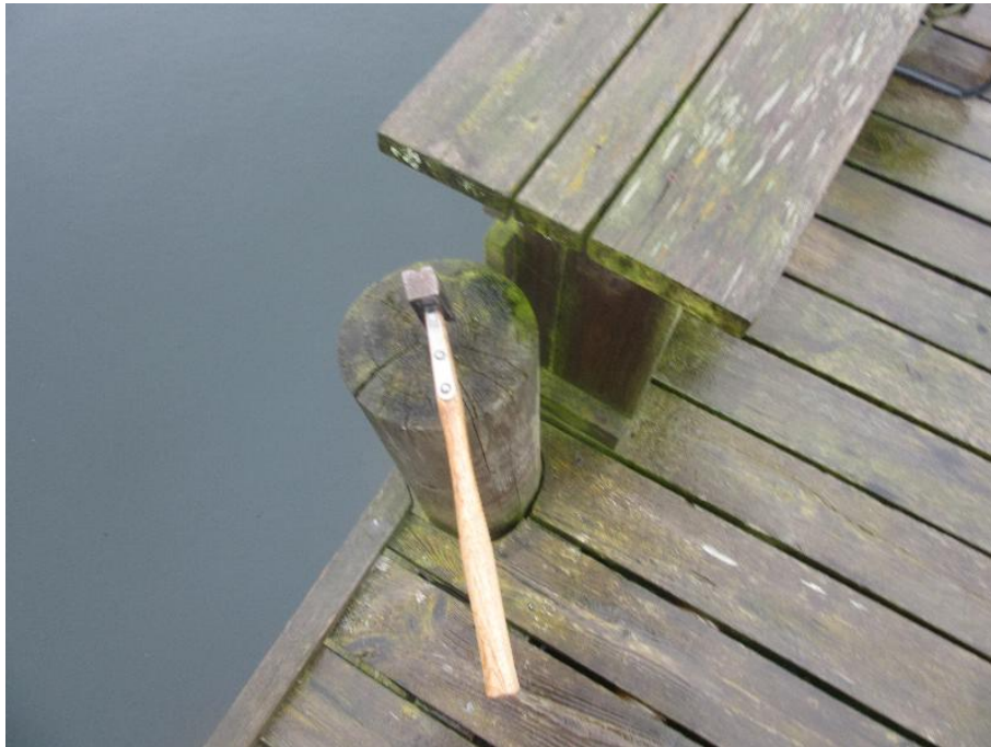
Manglende inddækning på pæletop ved plads P29.
