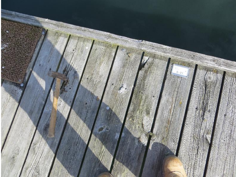
Nedbrudt bræt ved plads D 21
