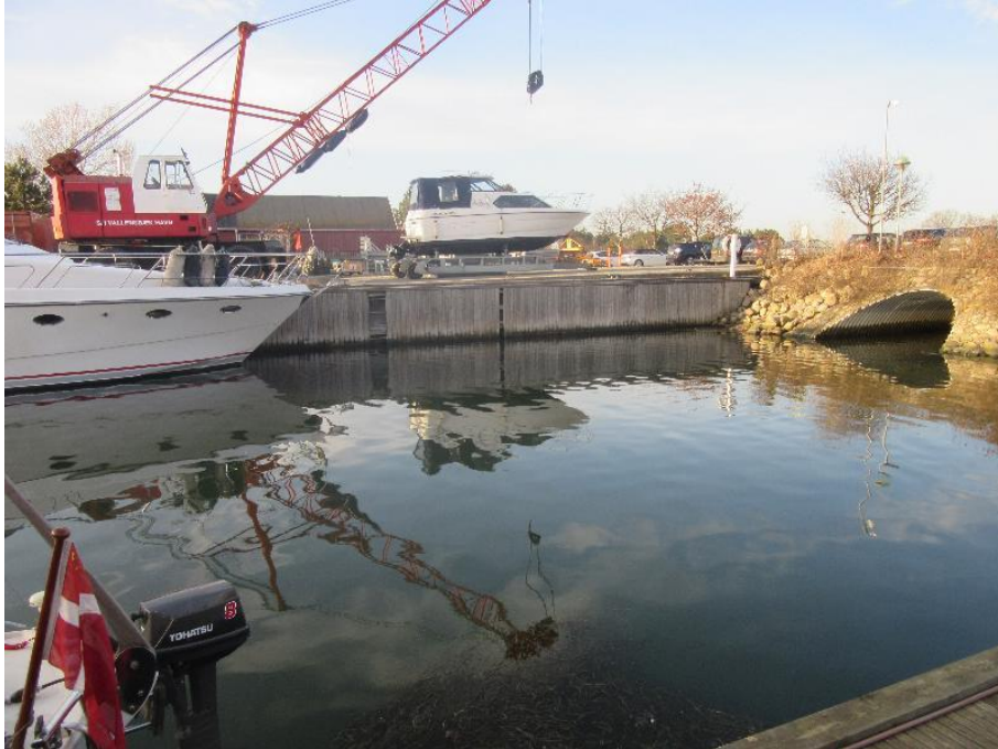
Manglende brædde på bølgeskærm.
