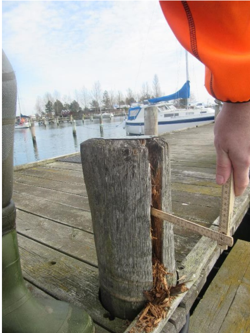
Nedbrudt top af pæl ved plads E146.
