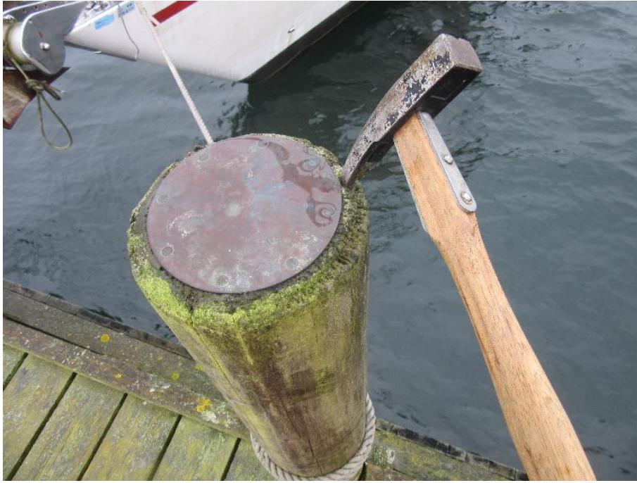
Nedbrydning i toppen af pæl ved plads Q111
