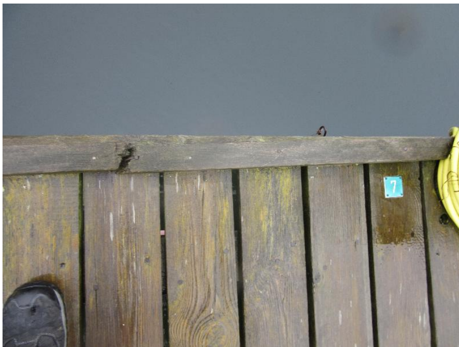
Ødelagt kantliste ved plads P7.
