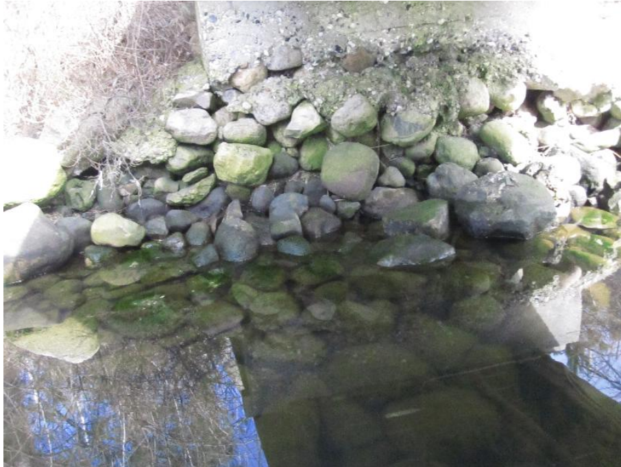
Stejl stensætning ved fundament.
