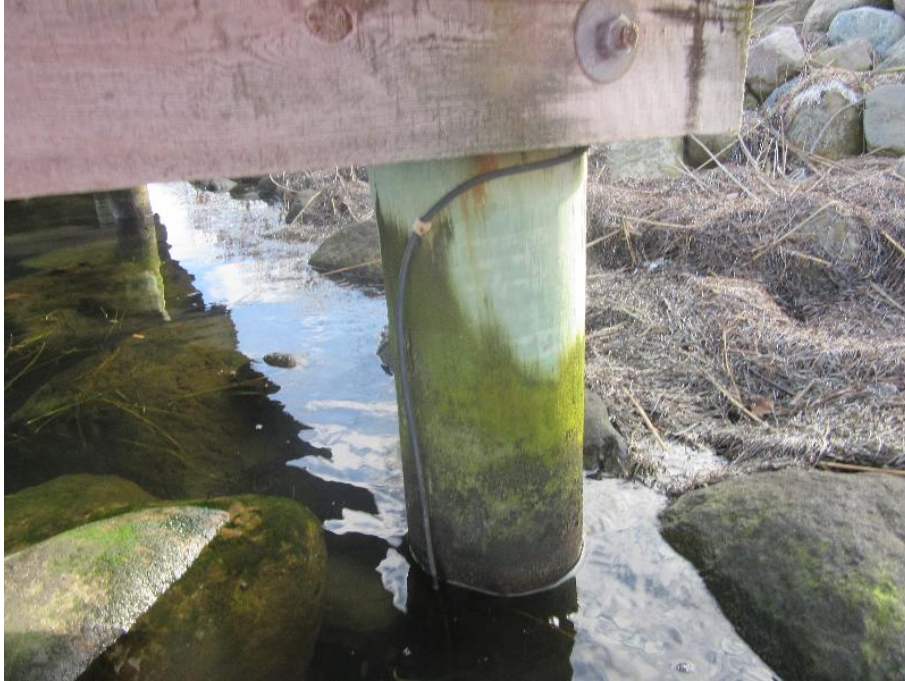
Pæle med misfarvninger ved vandspejlet.
