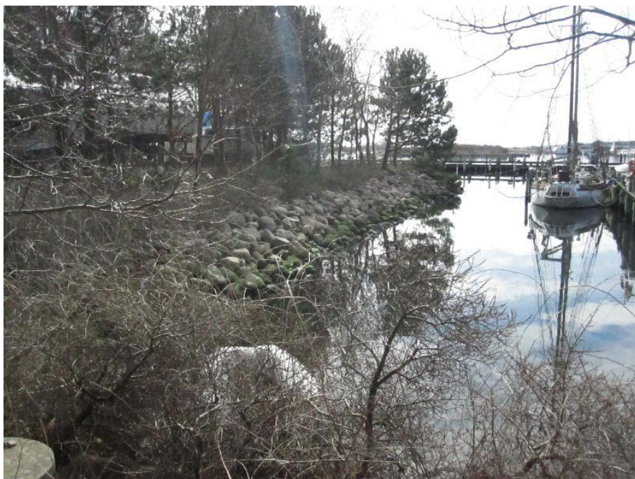
Acceptabel stensætning strækning F
