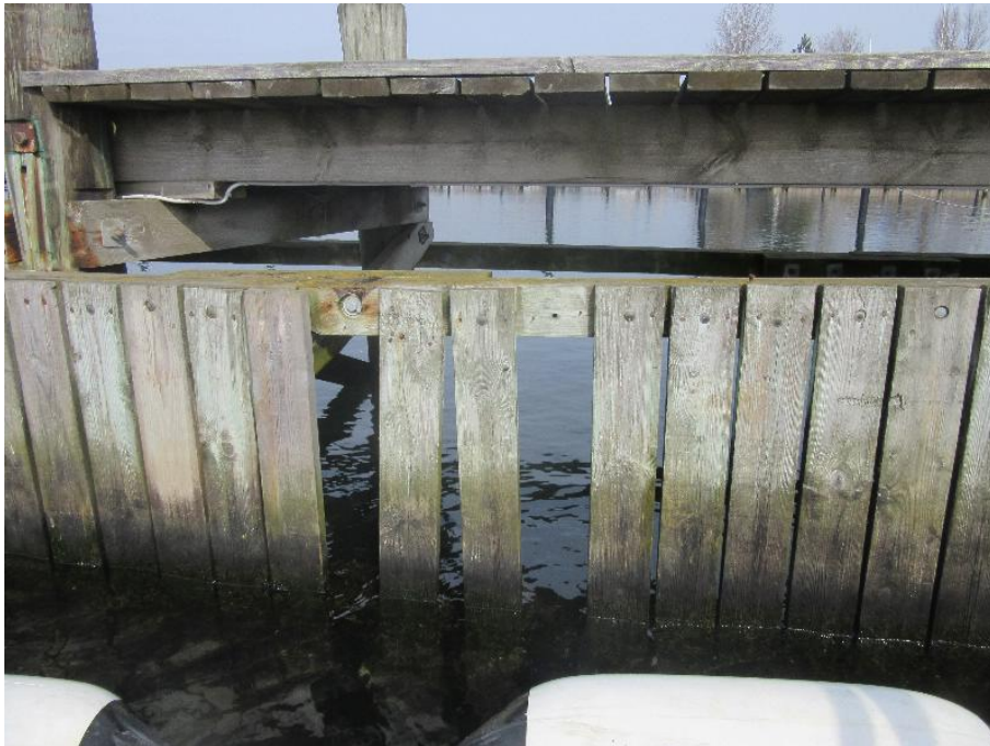
Manglende brædder i bølgeskærm.
