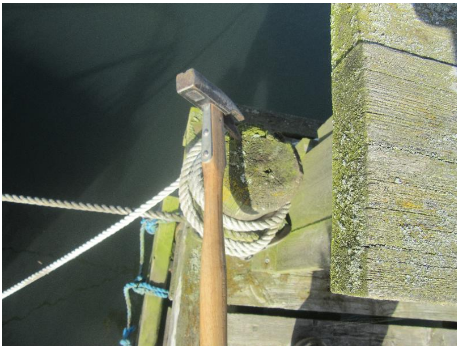
Top af pæl uden topinddækning ved plads K30.
