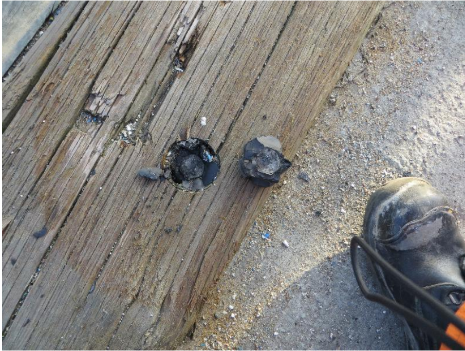
Knækket udfyldning omkring montagebolt
