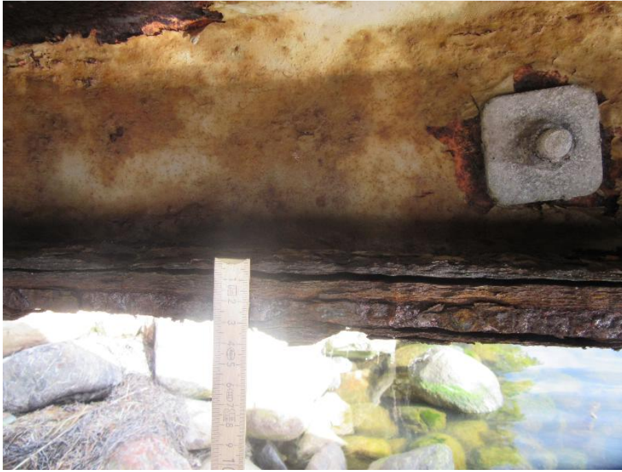
Svær korrosion af langsgående stålbjælker i det 1. fag fra land.
