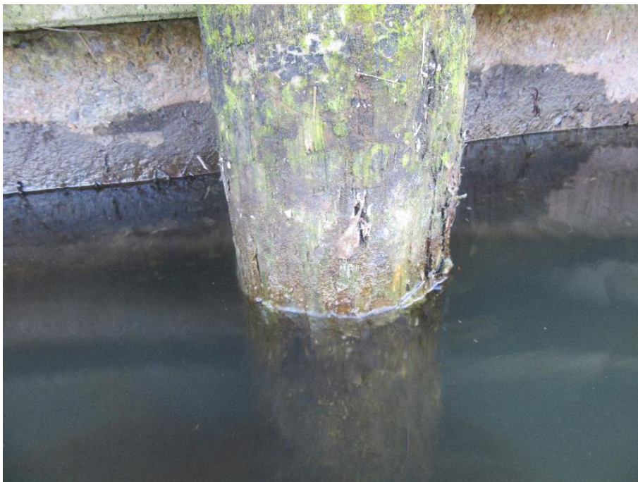
Pæl nedbrudt ved vandspejlet.
