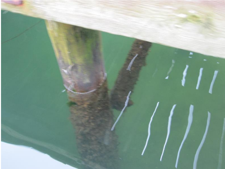
Løsrevet afstivning ved ramme 2 (talt fra land).
