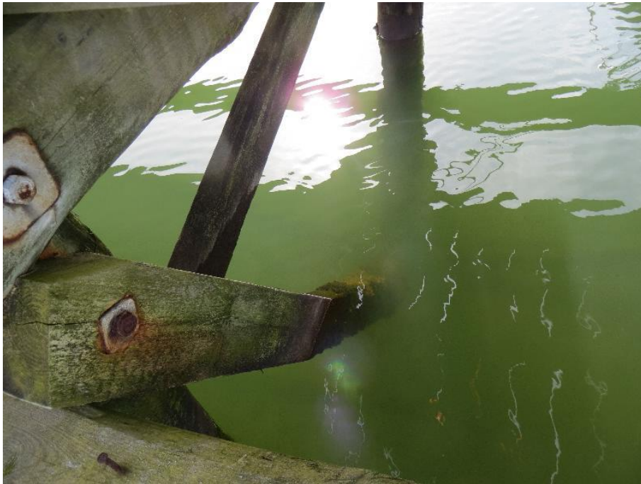
Tværafstivning løsrevet fra den ene pæl.
