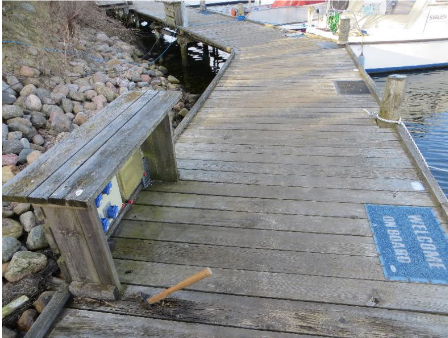
Nedbrudt bræt ved plads N39/40
