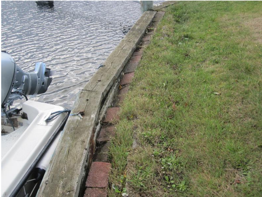
Ældet og nedbrudt hammer.
