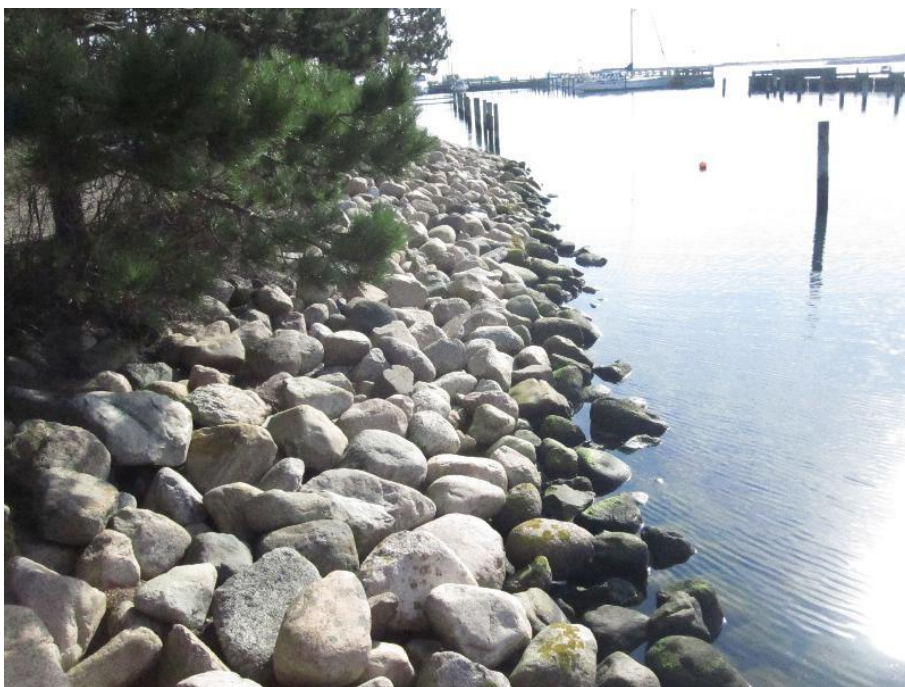
Acceptabel flad hældning af stensætning på strækning E.
