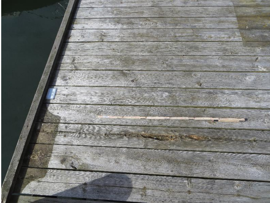
Dårligt brædt, ved plads G-27
