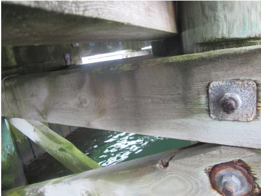
Ældet tværliggende bjælke
