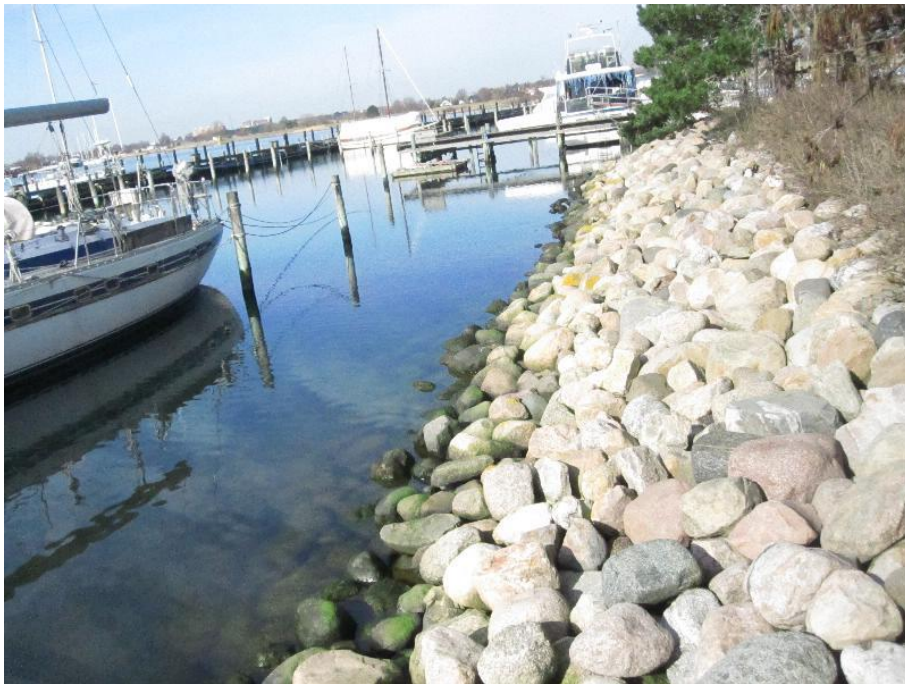
Acceptabel hældning af stensætning på strækning E.
